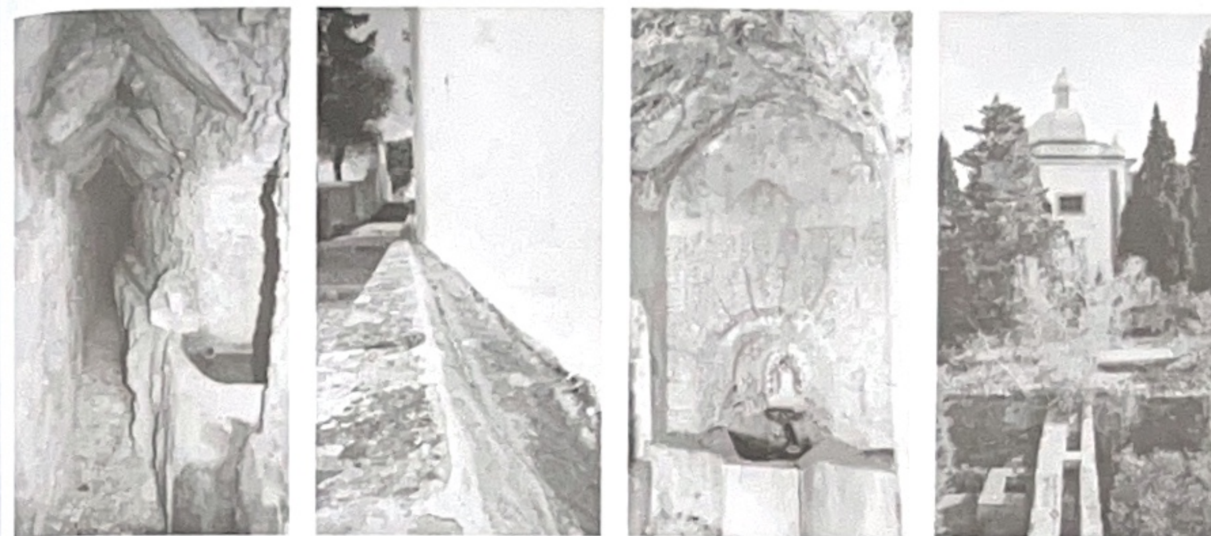
Parte dos elementos que compõem o sistema hidráulico do Convento da Arrábida (2022) Part of the elements that integrate the hydraulic system of the Convent of Arrábida (2022)
